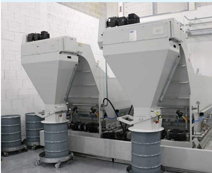
Wichtiger Bestandteil der KNOLL Filteranlagen ist der integrierte Automatikonzentrator, der dafür sorgt, dass der Hartmetallschlamm stichfest im Entsorgungsfass landet.
