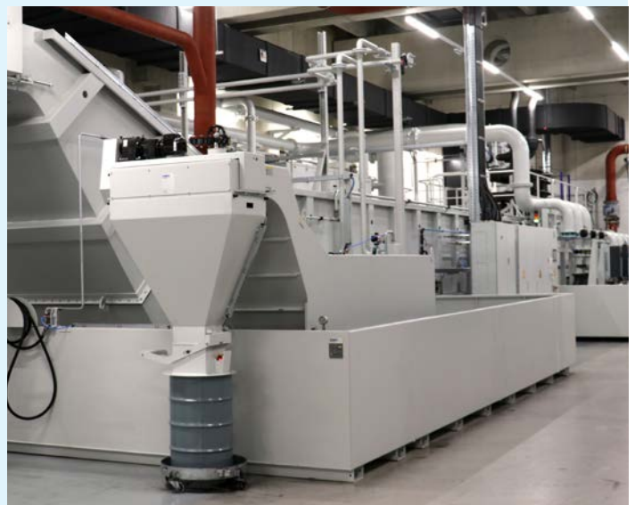
Wachstumsperspektive: Die KNOLL MicroPur®-Anlage zur Ölfiltration kann auf eine Kapazität von 10.000 l/min ausgebaut werden.
